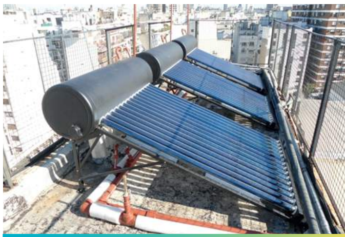
Instalación en la parte superior del hotel
